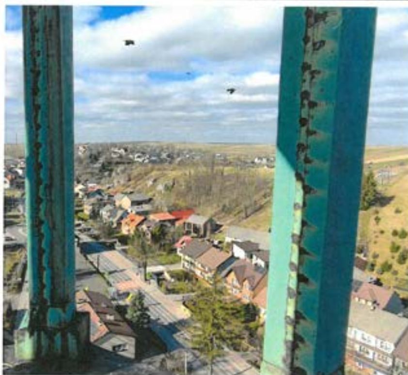
Fot. 30 Słupy helmu górnego obite blachą, widoczna korozja blachy
