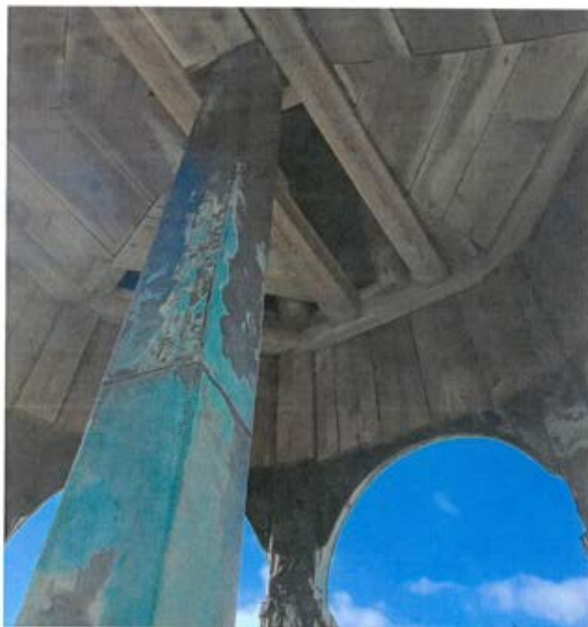
Fot. 29 Brak deskowania pod kopułą umożliwiającą nieograniczony dostęp ptactwa
