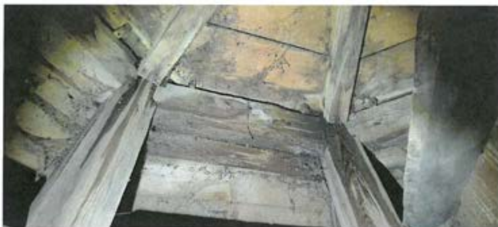
Fot. 21 Zawilgocenia belek obwodowych helmu górnego
