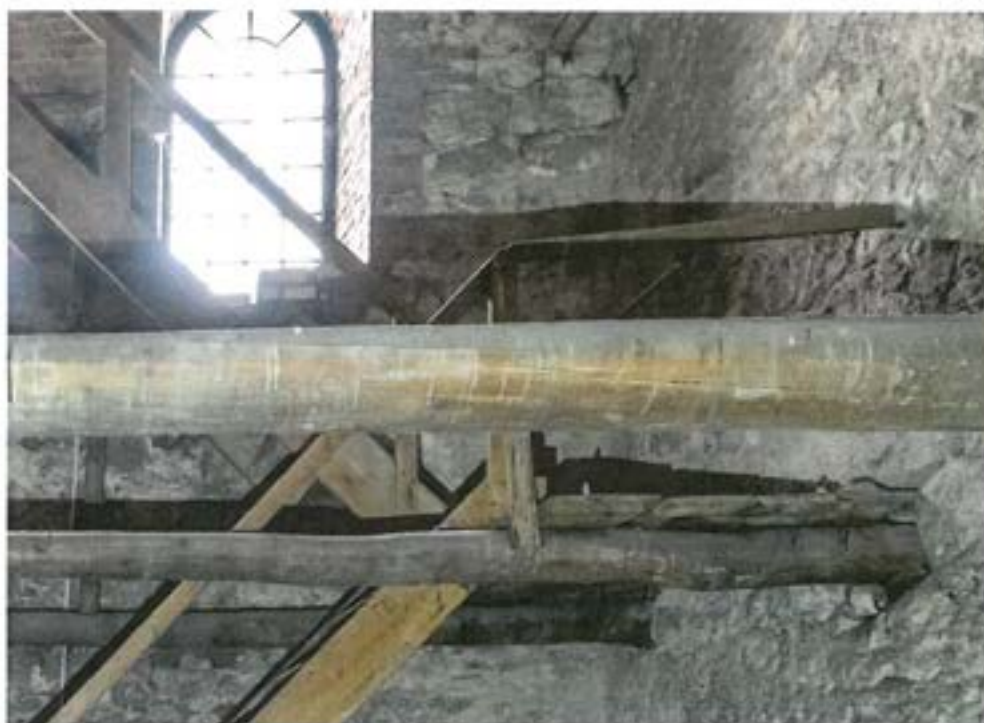
Fot. 3 Oparcie belki policzkowej na deskowaniu i bocznie do belki stropowej +15.31 m, brak belki spocznikowej
