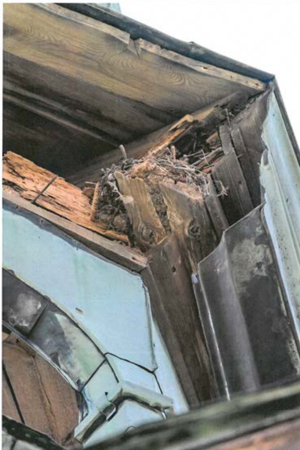
Fot. 26 Widoczna korozja drewnianej konstrukcji, nieprzybita blacha do pozostałej konstrukcji
