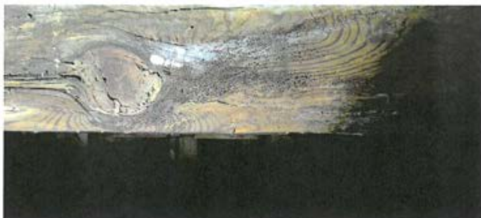
Fot. 23 Belka konstrukcji helmu górnego zaatakowana przez szkodniki drewna
