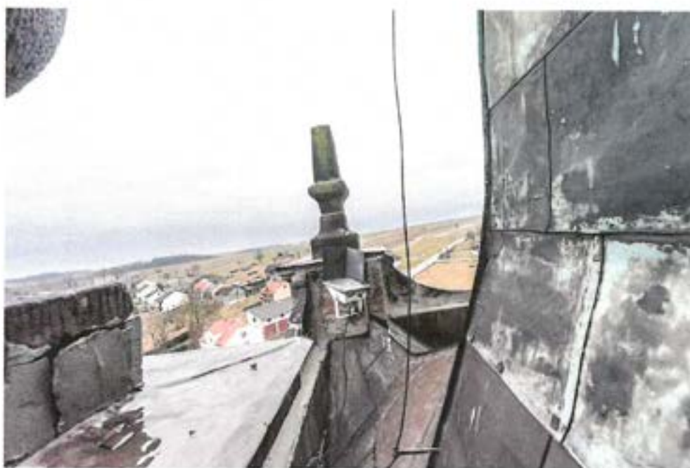
Fot. 31 Zwieńczenie konstrukcji murowanej części wieży, odspojony tynk
