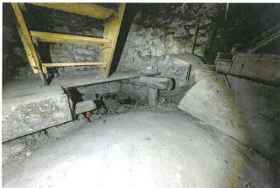
Fot. 2 Belki w poz. +12.21 m stanowiące oparcie dla konstrukcji schodów oparte na sklepieniu poprzez kilkunastocentymetrowe słupki. Brak belki spocznikowej
