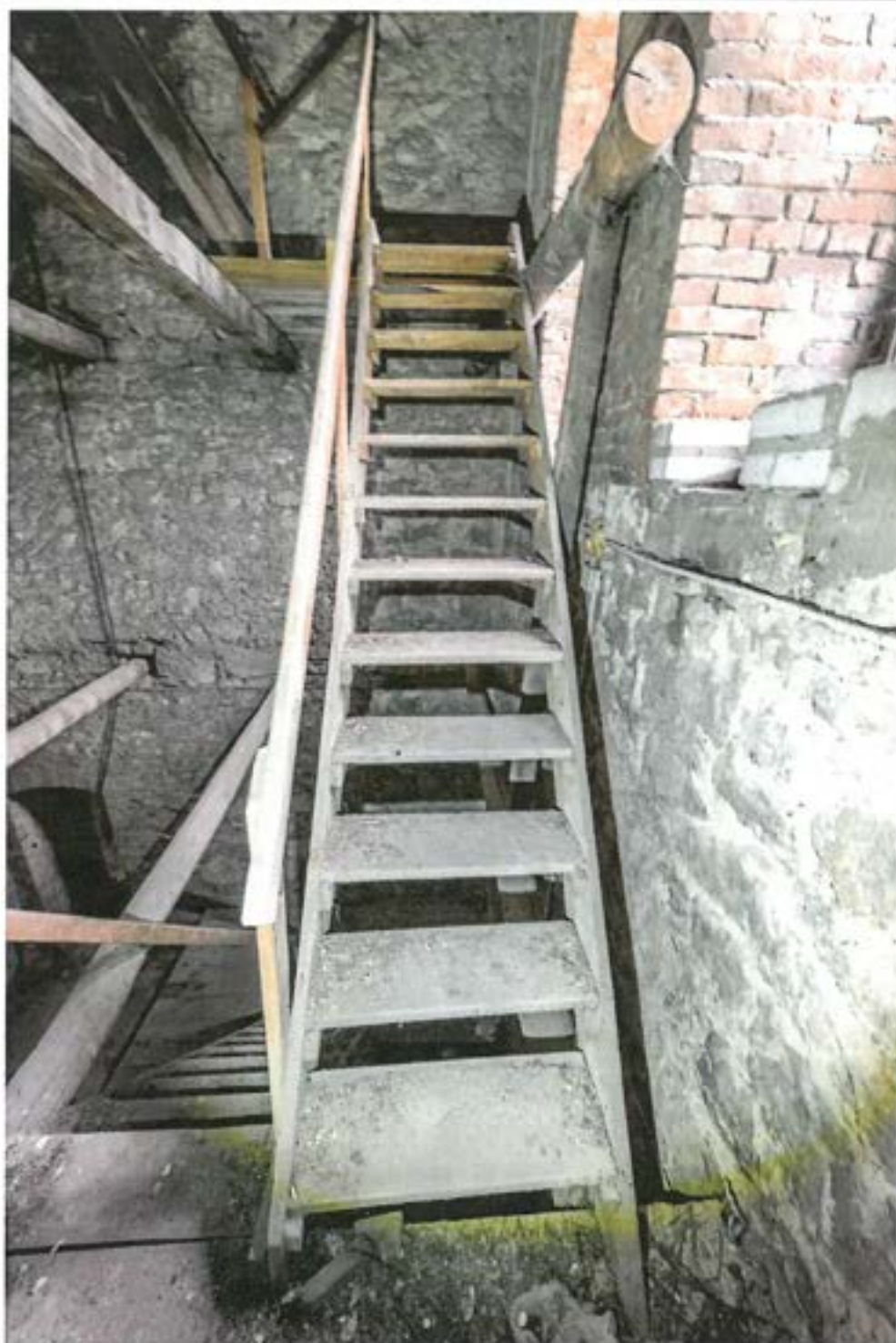
Fot. 5 Klatka schodowa- bieg pomiędzy poziomem 15.31 m, a 17.99 m. Obciążona belka stropowa oparta na konstrukcji stropu +15.31 m poprzez słupki 10x10 cm
