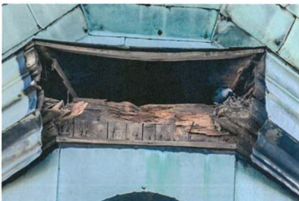
Fot. 24 Uszkodzenia helmu wieży, brak belki obwodowej, widoczna korozja drewnianej konstrukcji
