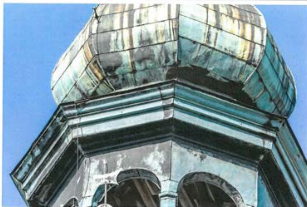
Fot. 28 Skorodowana blacha miedziana kopuły wieży
