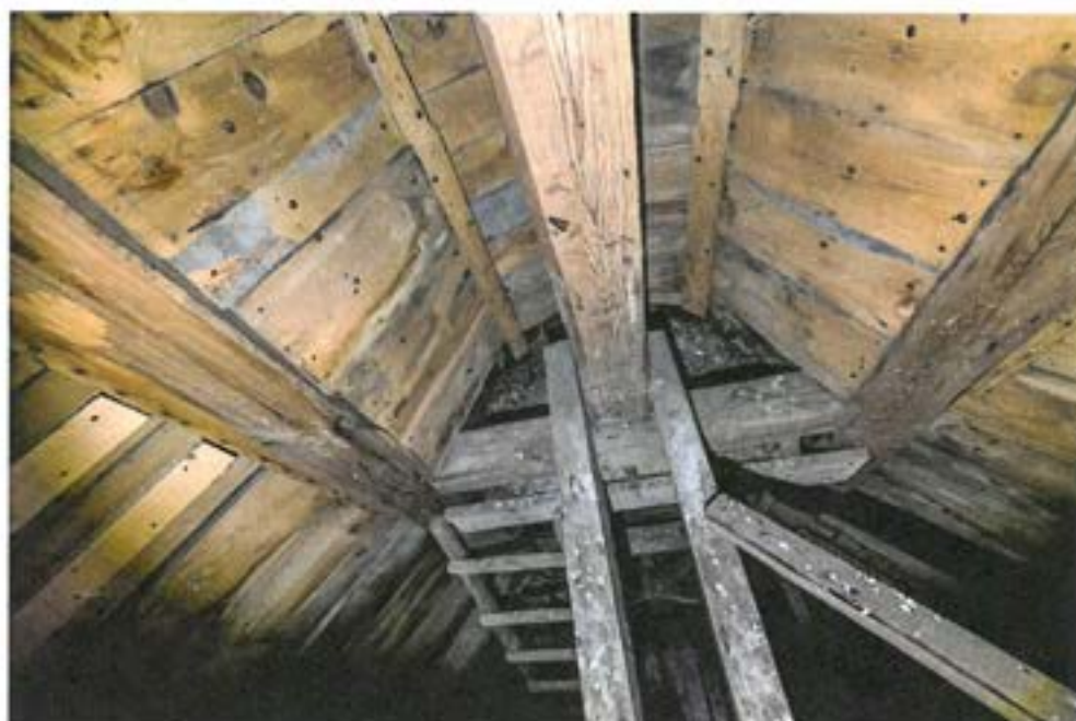
Fot. 17 Oparcie części przekroju słupa wieżyczki na deskowaniu; gałązki itp. naniesione przez ptactwo, uszkodzone deskowanie
