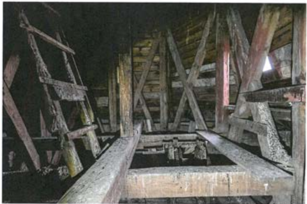
Fot. 15 Konstrukcja nośna hełmu dolnego, oparcie króla przez belkę środkową na podwaliny, konstrukcja zabrudzona ptasimi odchodami
