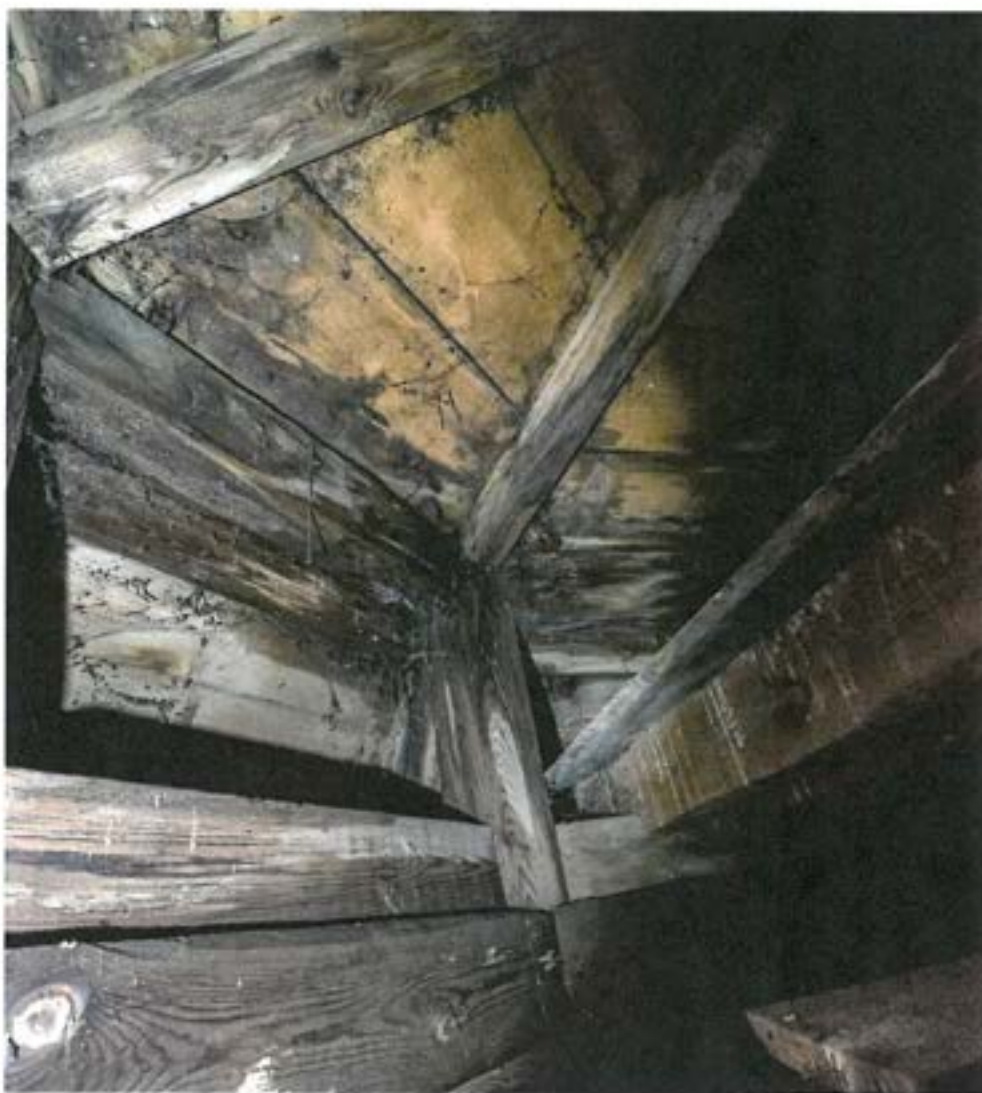
Fot. 22 Zawilgocone deskowanie i konstrukcja helmu górnego wieży
