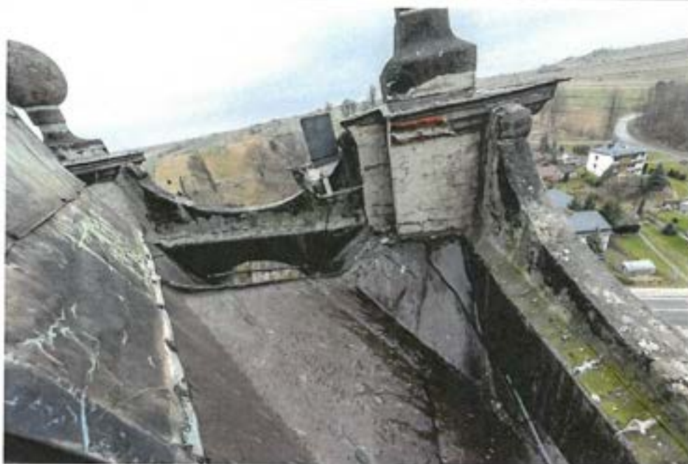
Fot. 32 Złusowana cegła, pęknięcia tynku zwieńczenia konstrukcji murowej
