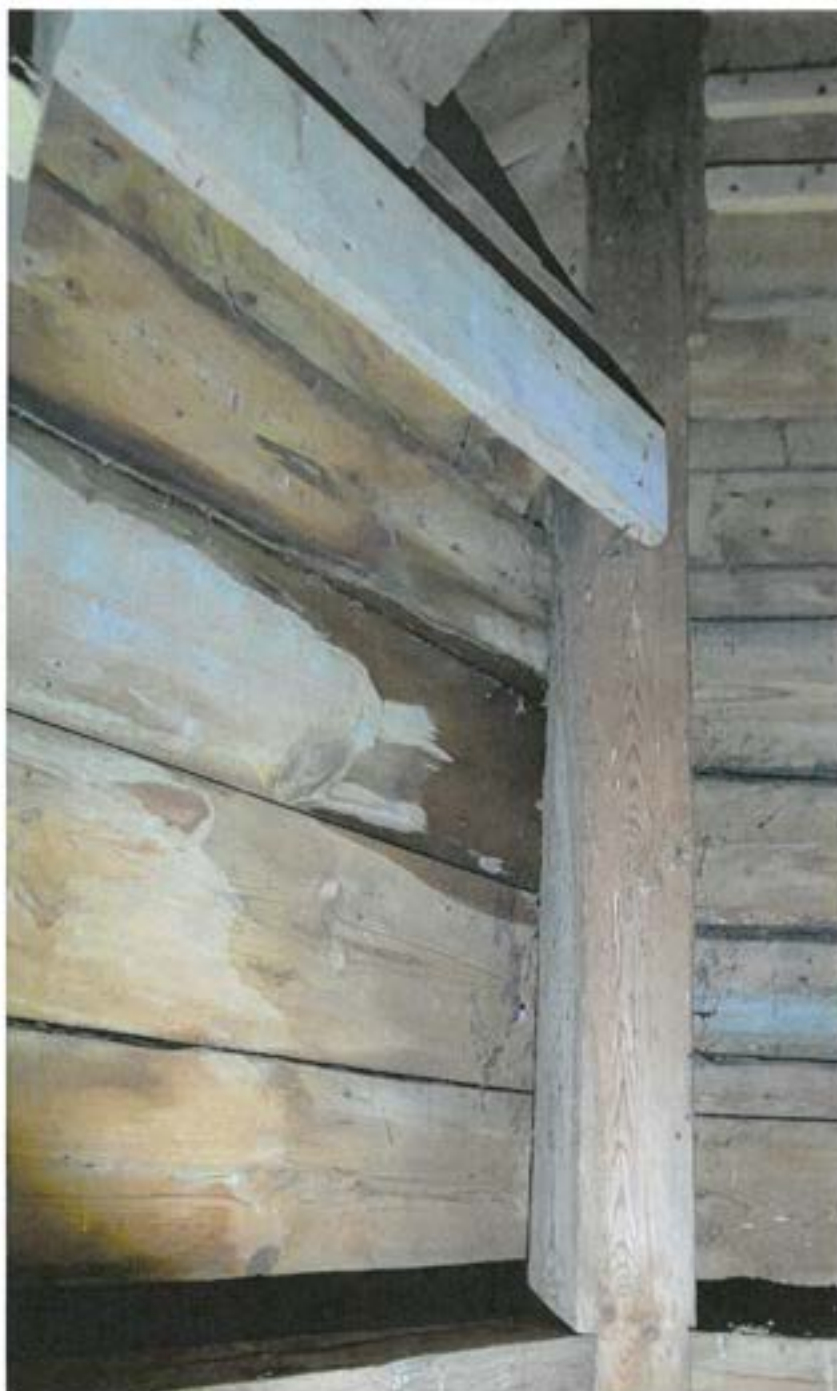
Fot. 18 Zawilgocone deskowanie helmu dolnego pod konstrukcją wieżyczek w narożnikach
