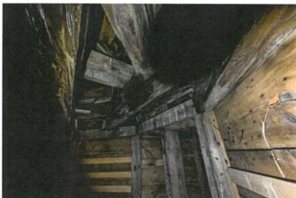
Fot. 20 Zawilgocona konstrukcja nośna podstawy helmu górnego
